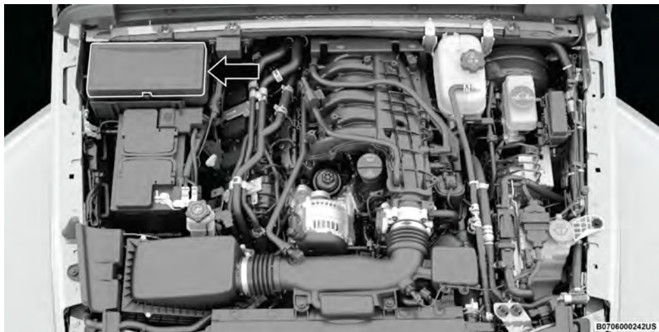
Ubicación del centro de distribución de energía
